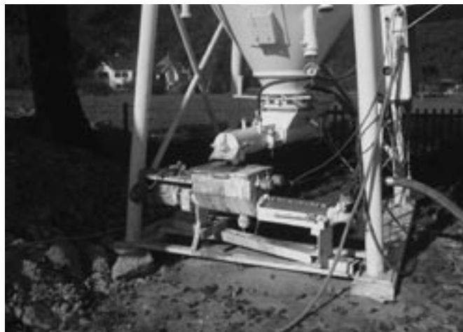
Bild 6: Durchlaufmischer und Schneckenpumpe am Trockenbetonsilo
