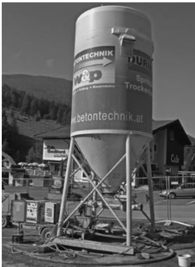
Bild 5: Trockenbetonsilo mit Misch- und Fördereinrichtung
