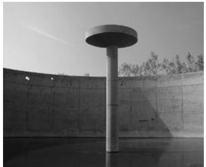
Bild 2: Fermenter mit Mittelstütze
