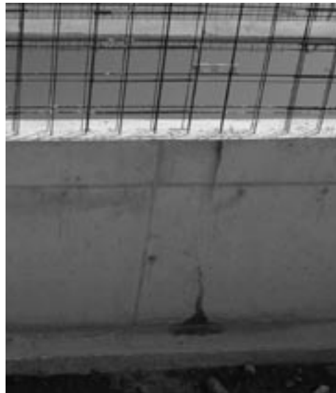
Bild 1: Undichte Stellen werden bei Wasserbefüllung sichtbar
