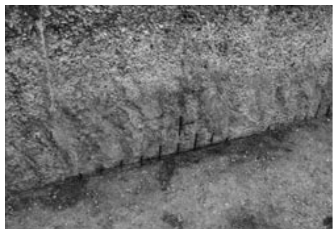
Bild 3: Gärsäuren können massiv den Beton angreifen – Schutzanstriche / Beschichtungen oder spezielle Betonzusammensetzungen sind für eine lange Lebensdauer unumgänglich
